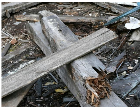
Разрушенные временем конструкции
